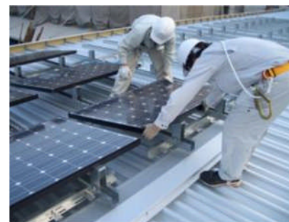
太陽光発電システムの導入
